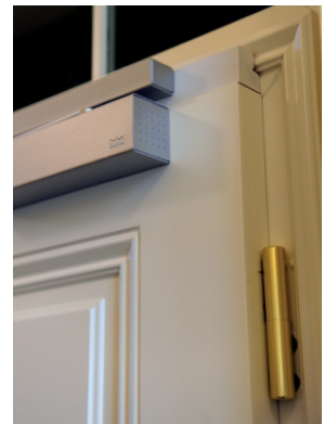
Brandschutztüre EI²30C mit Oberlichte.
